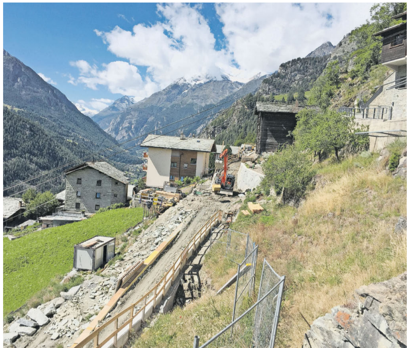
Im Fahrplan. Die Bauarbeiten für die neue Flurstrasse zum alten Dorfkern laufen auf Hochtouren.
